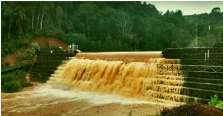
Figura 253 – Barragem de gabião, em operação
