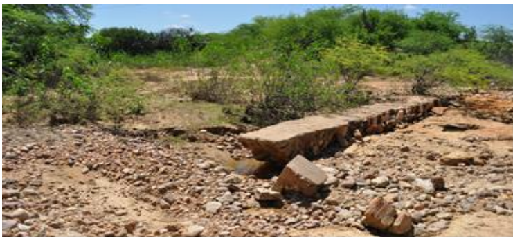
Figura 306 – Erosão causada pela desastrosa interferência
